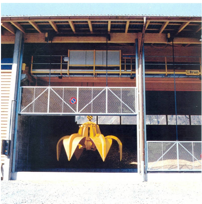
Krananlage im Holzschnitzlager (Foto IUB)
