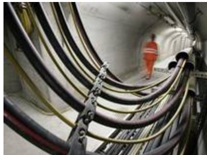
Kabelkeller (Foto BLS AT)
