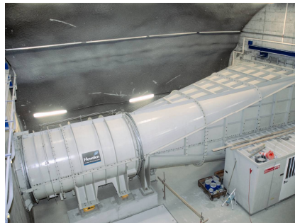
Tunnellüftung (Foto TU ABL)
