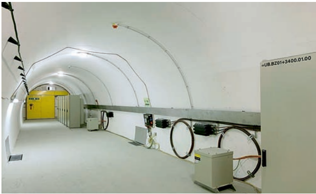
Bild 14: Elektrische Ausrüstung Querschlag.
