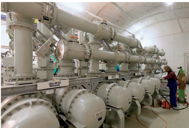
Bild 7: SF 6 -Schaltanlage 2AC 132 kV 16,7 Hz Unterwerk Mitholz.
