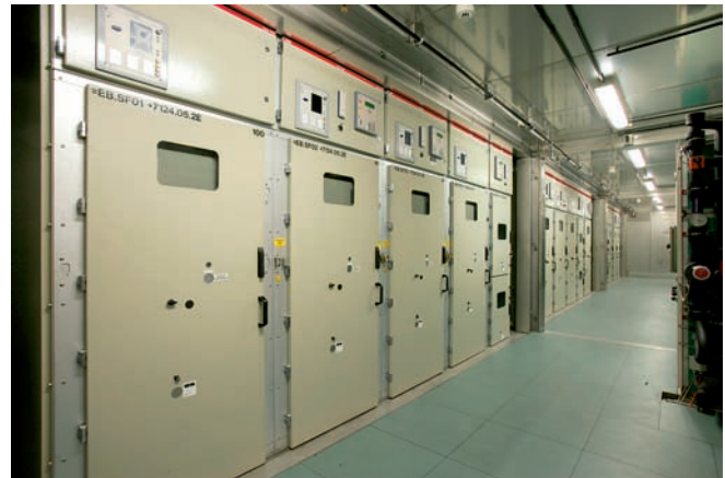
Bild 9: Schaltanlage 1AC 15kV 16,7 Hz in Betriebszentrale (Bild 4).
