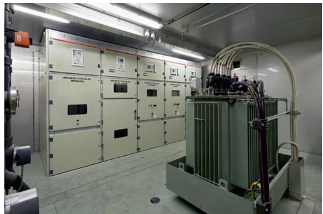
Bild 12: Transformatorstation 3 AC 16 kV/400V 50 Hz in Betriebszentrale (Bild 4).
