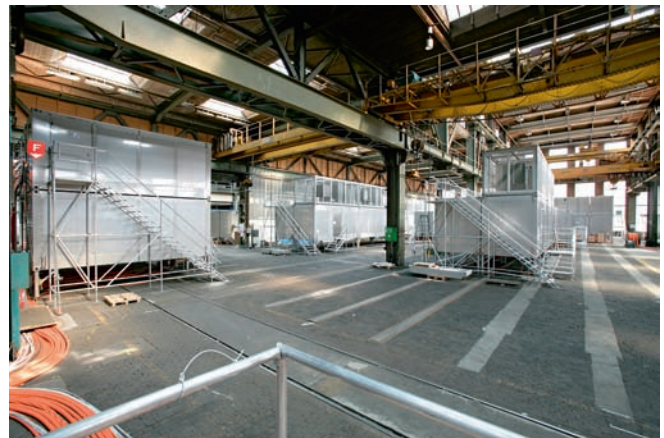
Bild 1: Prüfung der in Container eingebauten Bahntechnik-ausrüstung in einer Fabrikhalle in Bern.
